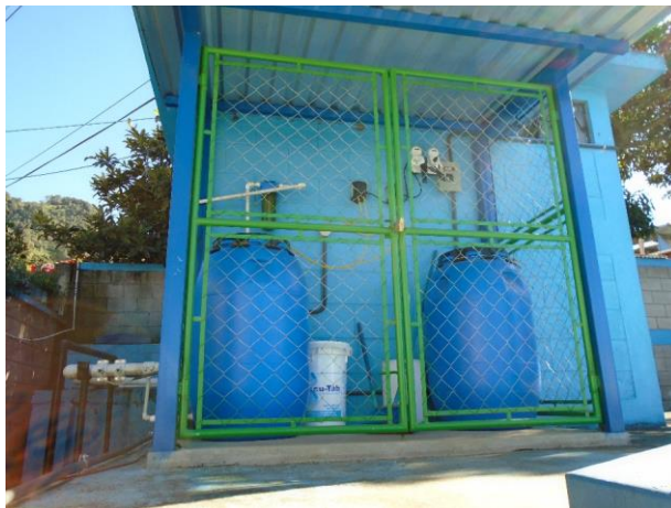
Foto: Sistema de cloración instalado en tanque de almacenamiento de agua ubicado en Cantón San Ramón
