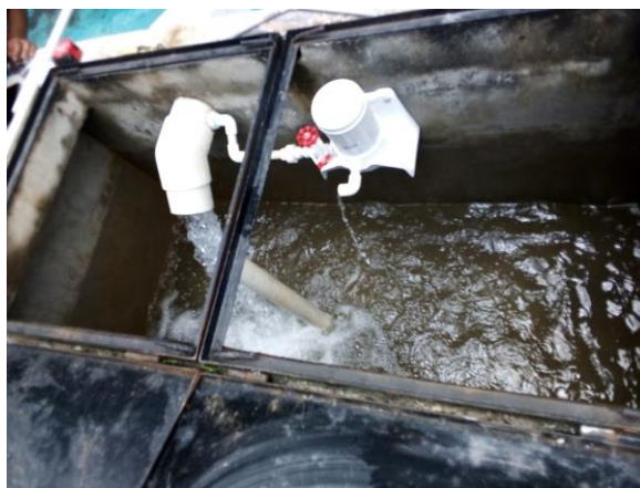
TIPO DE CLORADOR INSTALADOS, QUE SE MONITOREARON
