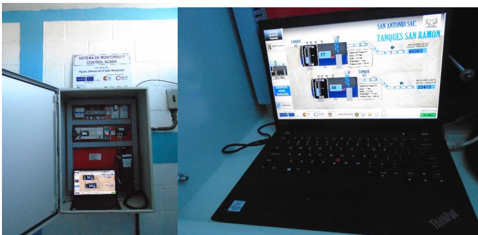
Foto: Sistema de control SCADA, instalado en tanque de almacenamiento de agua
